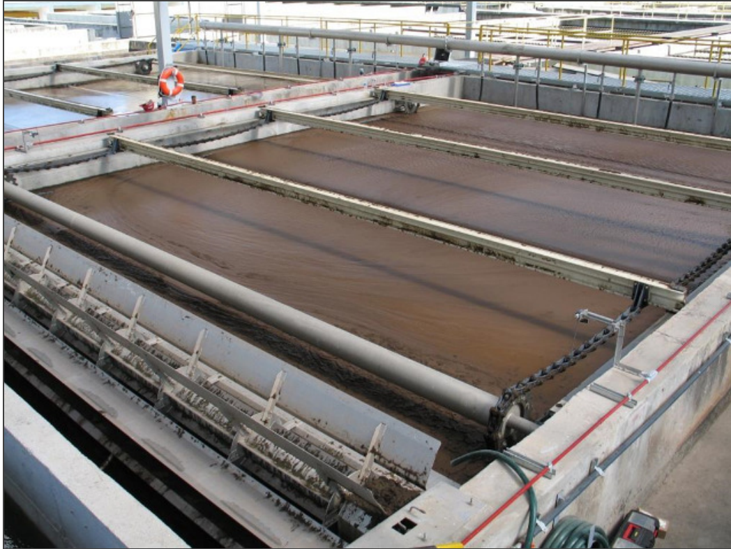
Hình 2: Nhà máy xử lý nước 163.200m 3 /ngày áp dụng FLOTOFILTER tại Guadalajara–Mexico
