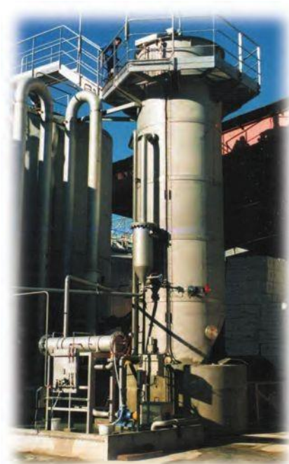
MCV 20 Xử lý nước thải nhà máy giấy và khử mực in
